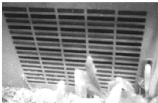
常時稼動する床下換気扇
